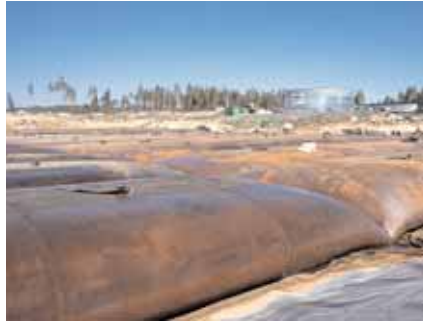
Geotuber som fyllts med muddermassor. Vattnet som rinner genom väven går till reningsverket i bakgrunden.
